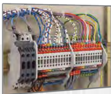
► Usporiadanie káblových zväzkov pomocou vyvážovacích pásovk
