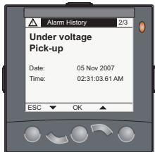
Alarmy: nábeh a odpad
